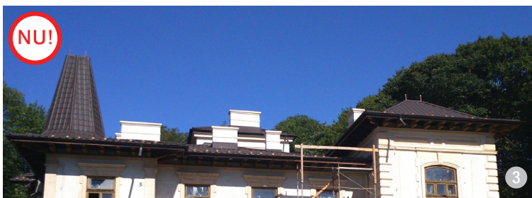
AȘA NU: Exemplu de intervenție incorrectă la acoperișul unei construcții cu arhitectură valoroasă, prin modificarea volumetriei și montarea unei învelitori neadecvate; în imagini, clădirea înainte de intervenție (sus) și după intervenție (jos).
